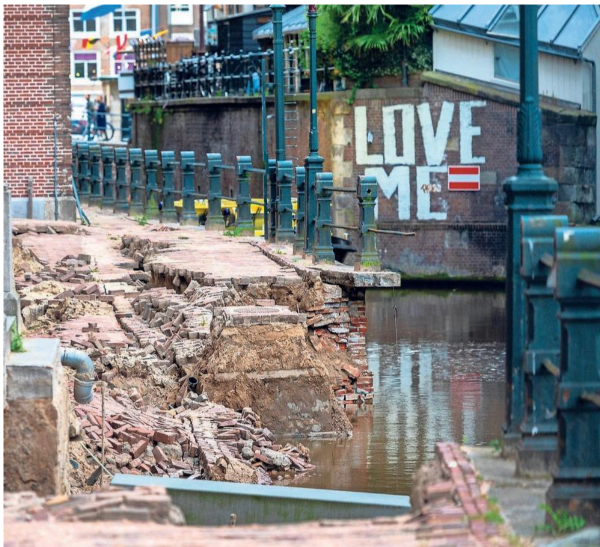
Bij de Binnengasthuisstraat langs de Grimburgwal in Amsterdam is onlangs een kademuur ingestort.
